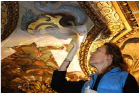
Le chantier de restauration de la galerie d'Apollon : consolidation d'un grotesque © M. Lombard
